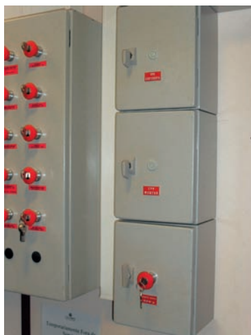
Figura 32 Cortes de emergência das UPS. Fonte: Centro Comercial Colombo. Lisboa, 2009.
