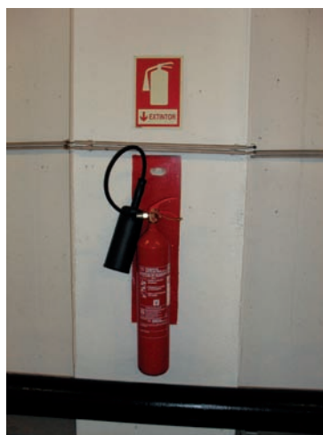
Figura 21 Extintor portátil de CO 2 .
