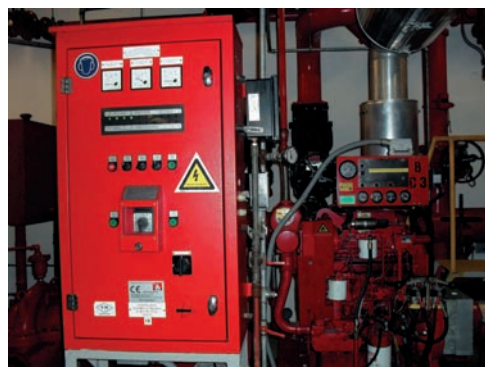
Figura 24 Motobomba e respectivo quadro de comando. Fonte: Centro Comercial Colombo. Lisboa, 2009.
