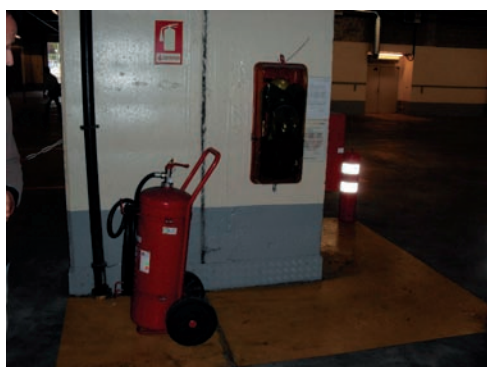
Figura 22 Extintor móvel e equipamento de protecção individual para as equipas de intervenção.
