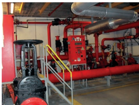
Figura 23 Vista do grupo hidropressor (1 motobomba e 2 electrobombas). Fonte: Centro Comercial Colombo. Lisboa, 2009.
