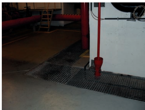
Figura 25 Drenagem das águas. Fonte: Centro Comercial Colombo. Lisboa, 2009.
